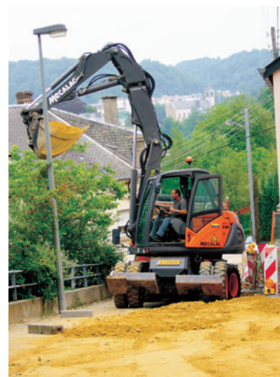
▲ La strada è stretta, scoscesa, è un cantiere difficile e molto tecnico
